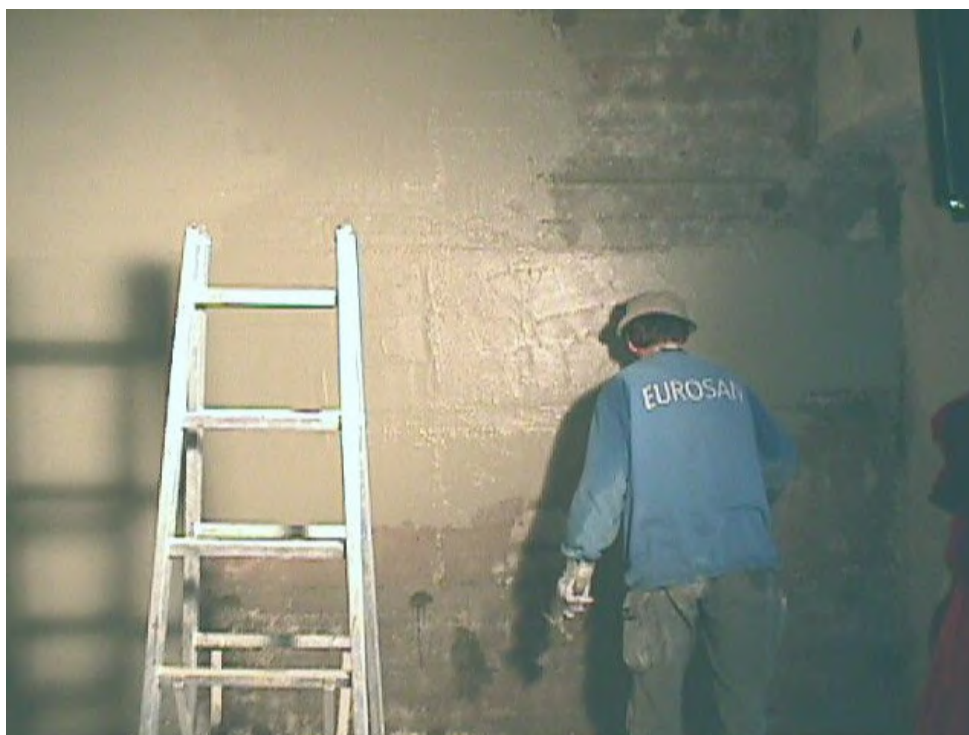
Prace renowacyjne i uszczelniające na dużych powierzchniach zawilgoconych, obciążonych solami ścian betonowych w garażu podziemnym z zastosowaniem CEMBOND M-945
